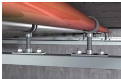
Подпятник на монтажной шине
