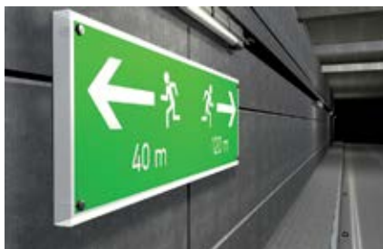
Знаки аварийного выхода в туннелях
