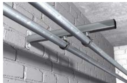
Трубопроводы, закрепленные на консолях
