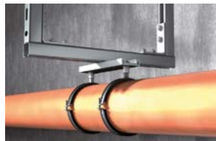
Крепление трубопровода на подвижной опоре
